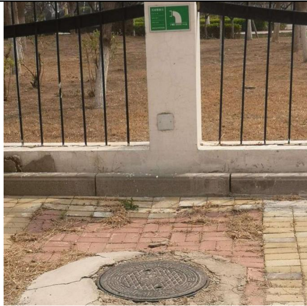
药研院 09 地块现状污水总排口
